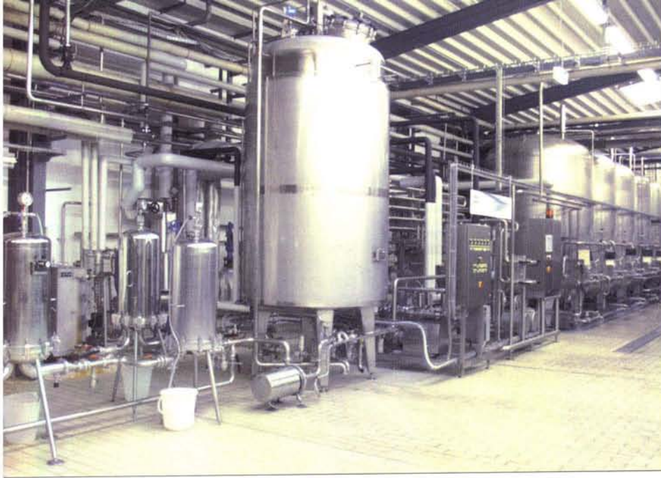
Ganz rechts stehen 6 Puffertanks à 11 000 l, von dort gelangen die trüben Getränke über Pasteurisierung, Kühlung und CO 2 -Imprägnierung im Cavitator zum Abfüll-Puffertank, die klaren Getränke werden zuvor noch membranfiltriert (ganz links).
